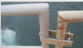
Protezione da corrosione pesante
